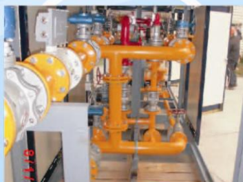
贵州惠水临时储配站 型号：JE-1000+500D31M
