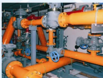
贵州燃气乌当LNG站 型号：JE-12000D31M
